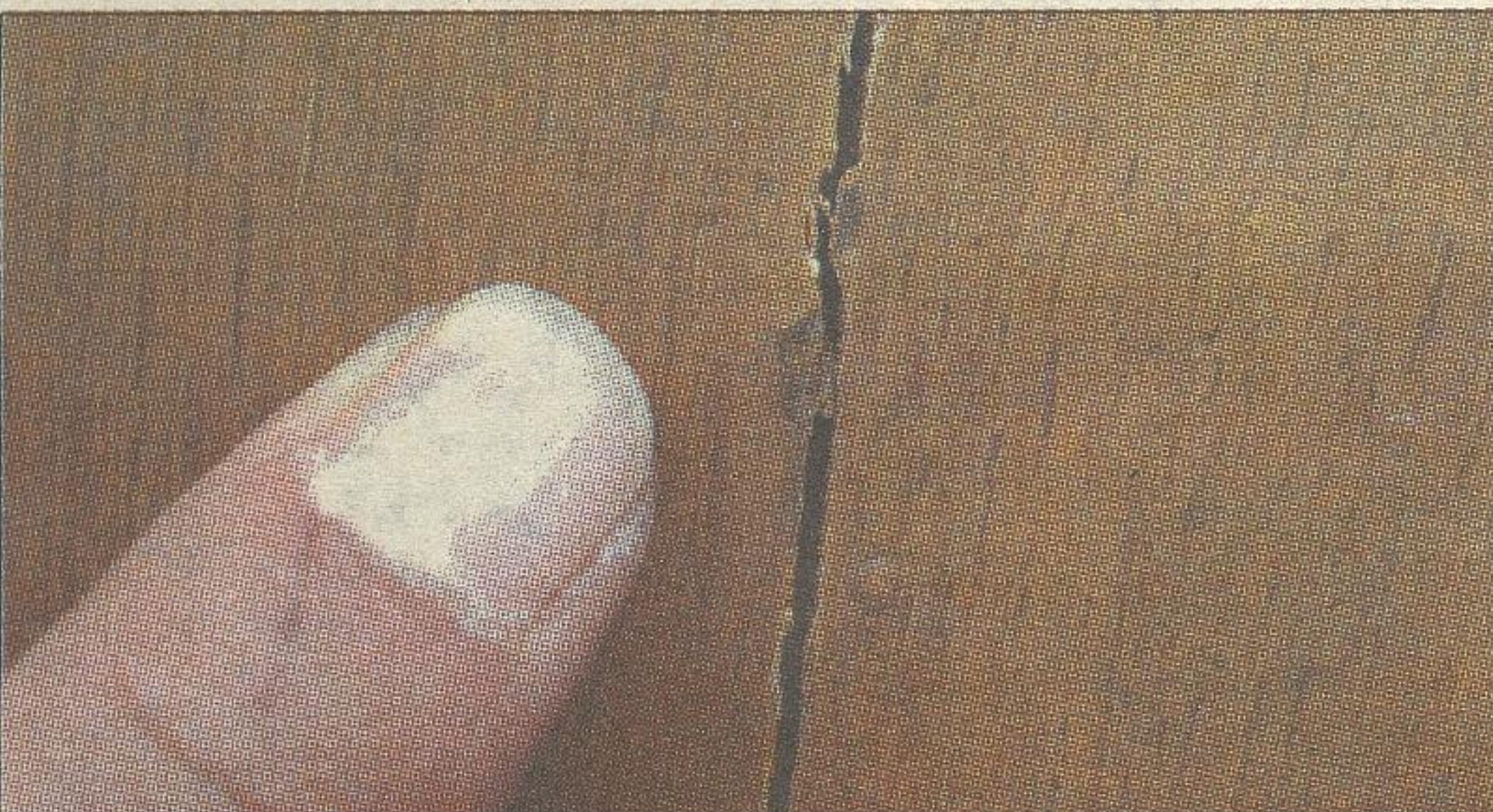
Drzwi są popękane i nie nadają się do użytku
