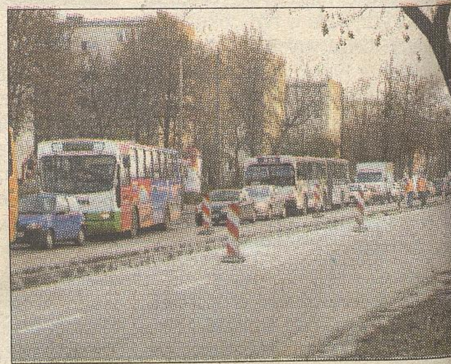
Codziennie kierowcy jadący z centrum tkwią w kilkusetmetrowym korku. Lepiej więc omijać ulicę Antoniukowską.
