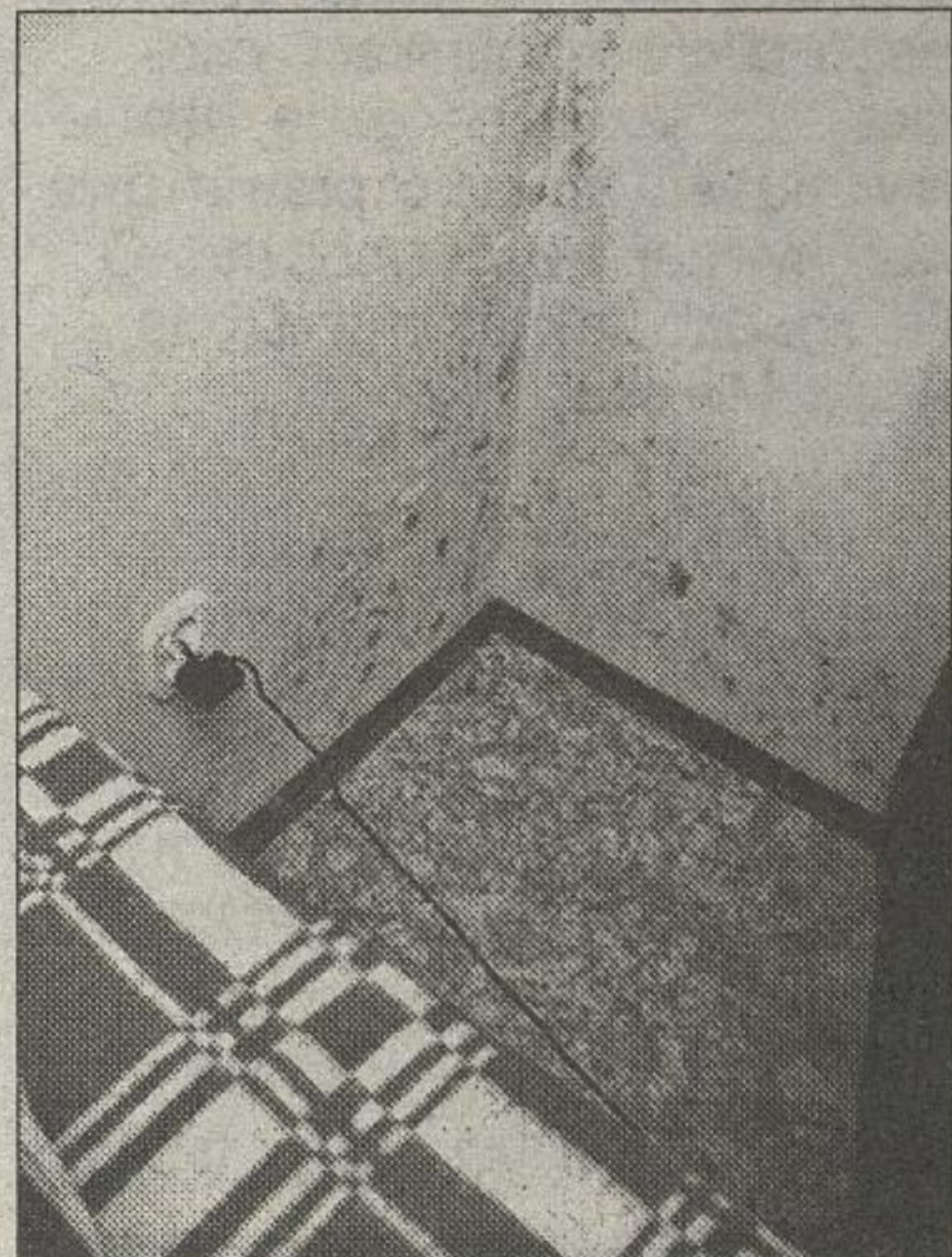
W kątach mieszkania na ścianach pojawiła się wilgoć i pleśń
