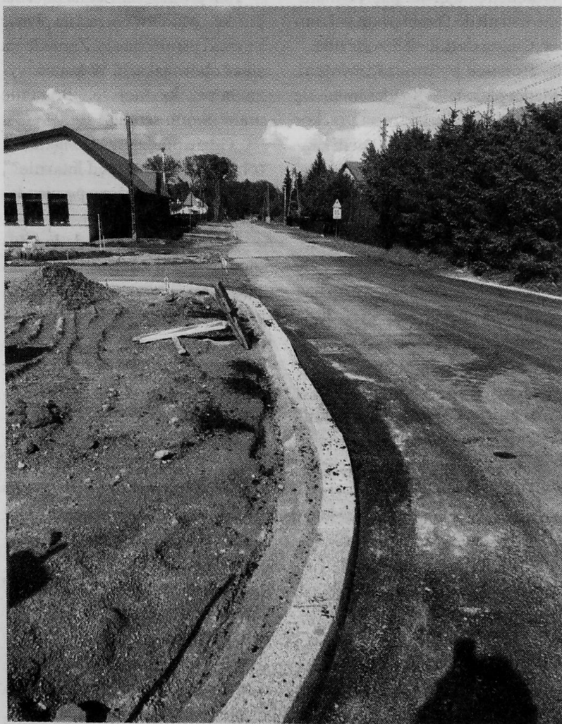
Ścięty łuk na samym skrzyżowaniu, a przecież miejsca jest tyle, by naprawdę był łagodny
