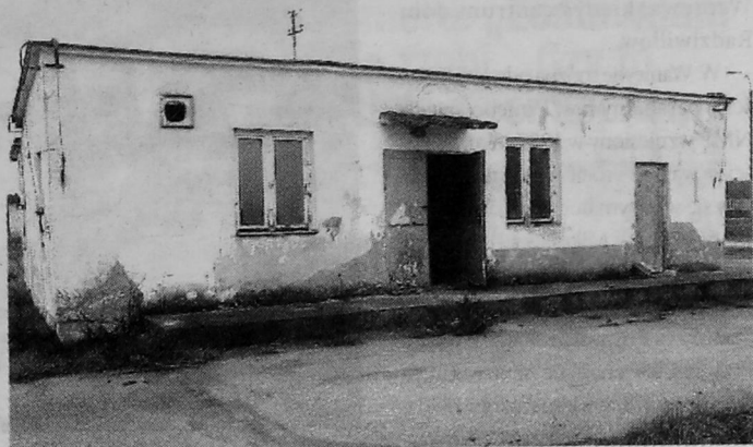
Zlewnia przed remontem
