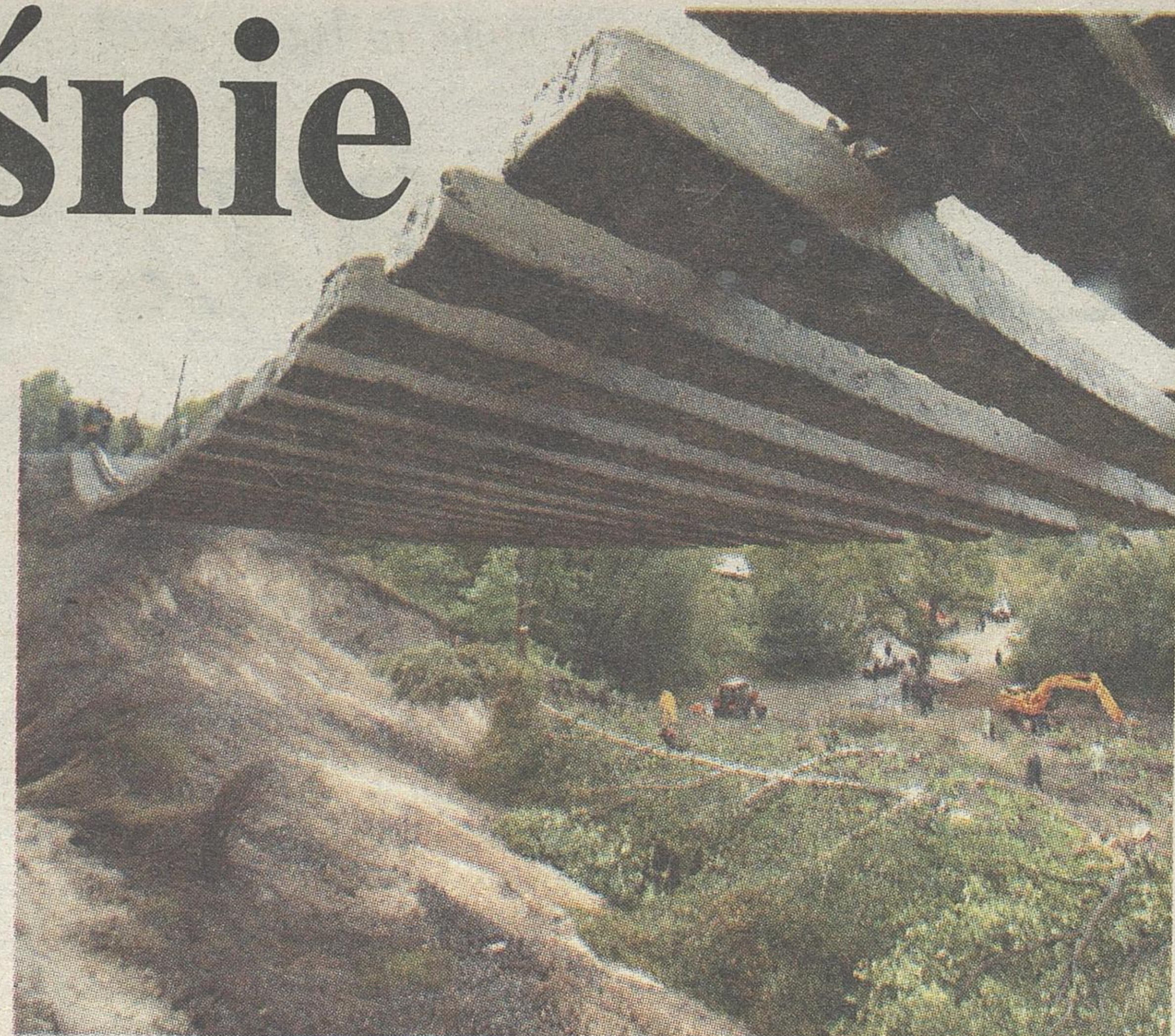
Miejscowość 35 kilometrów od Kaliningradu. Fragment torów kolejowych zniszczonych podczas wtorkowego trzęsienia ziemi o sile 4-5 stopni w skali Richtera.
