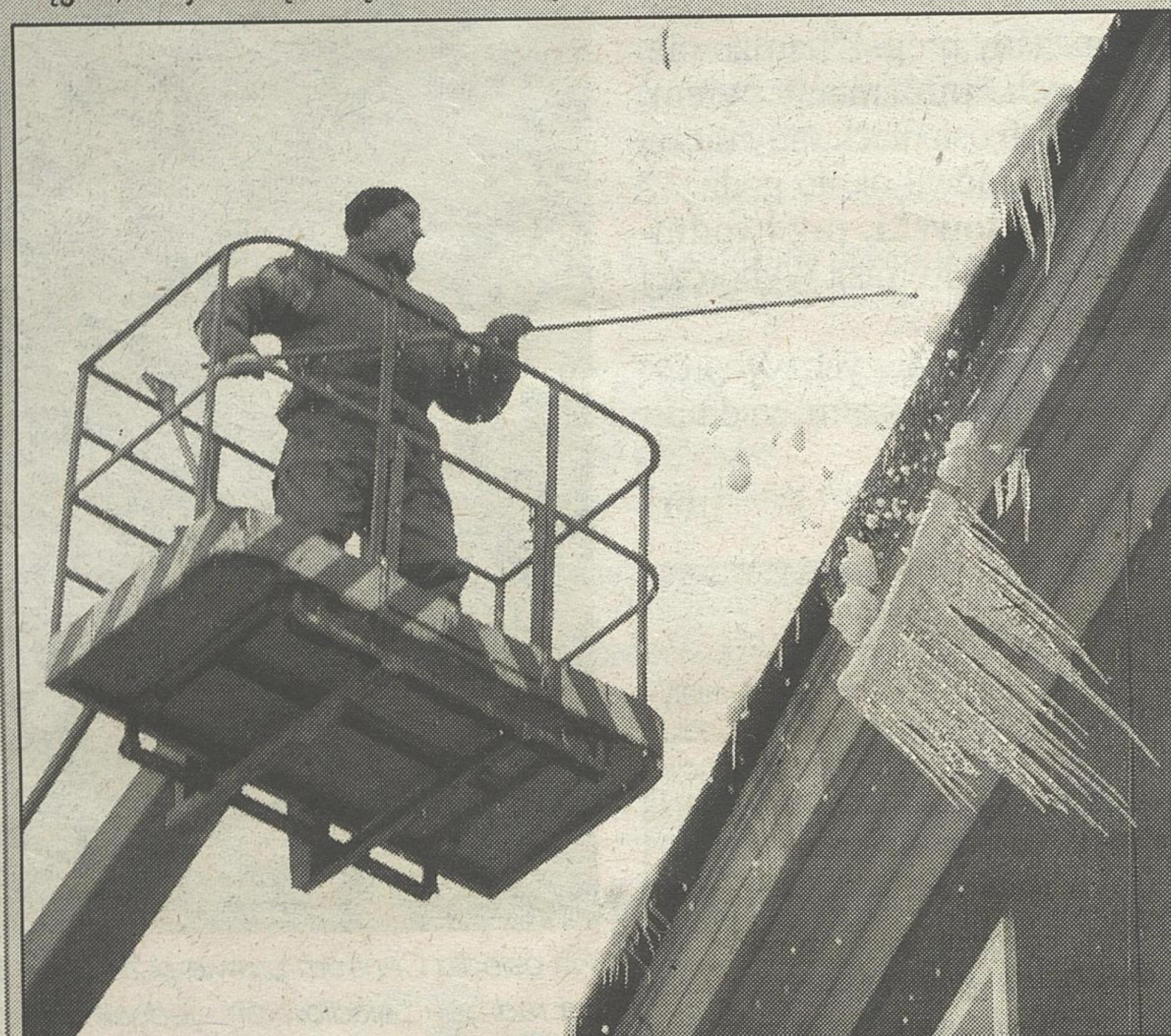
W trakcie wykonywania tego typu prac lepiej nie przechodzić pod budynkiem – spadające z dużej wysokości sople mogą być bardzo niebezpieczne.
