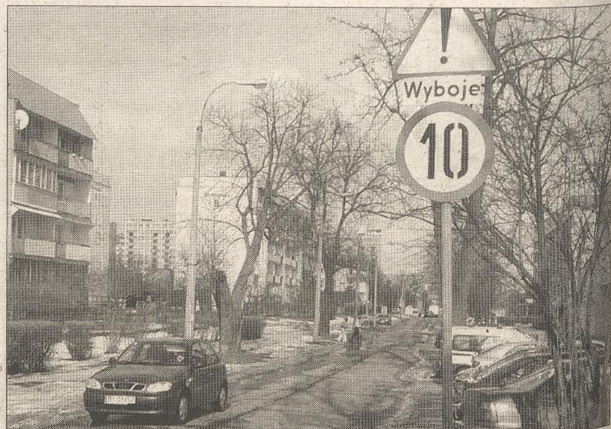
Ulica Kozłowa jest dziurawa niczym szwajcarski ser. Urzędnicy zamiast ją wyremontować, ustawili znaki ograniczające prędkość do 10 km/h!!!
