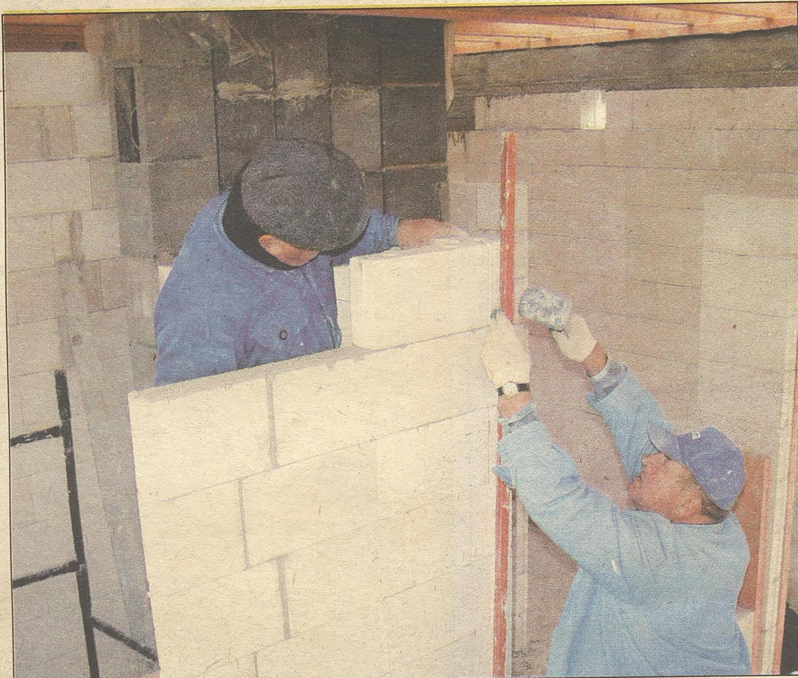
Ściany działowe z Silki E zapewniają komfort akustyczny pomieszczeń
