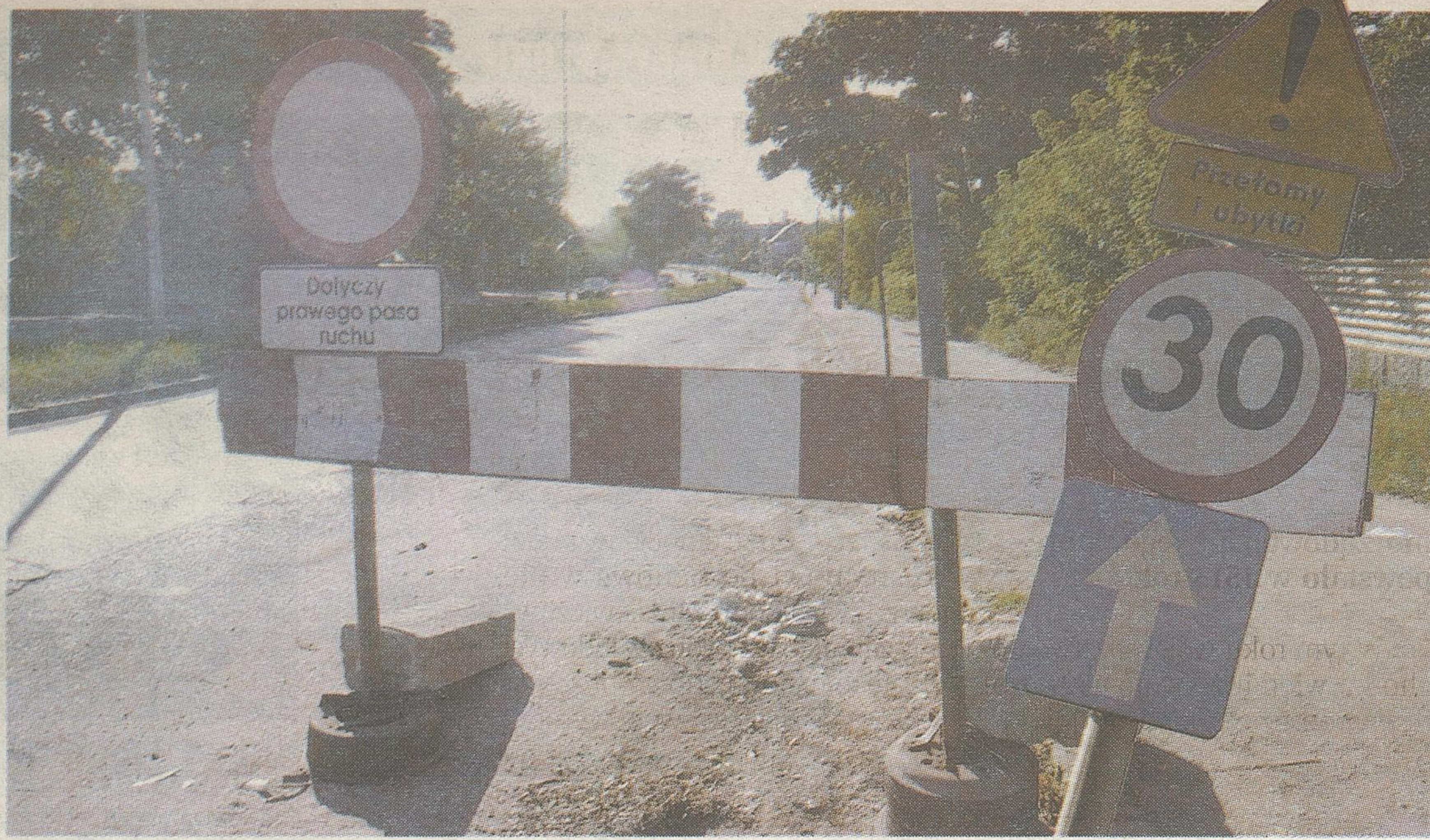
Wiele głównych ulic Białegostoku jest w tragicznym stanie. Na ulicy Kopernika z powodu dziur w ogóle zamknięto jeden pas ruchu. Nic dziwnego, że kierowcy mają już tego dość i chcą pozwać prezydenta do sądu
