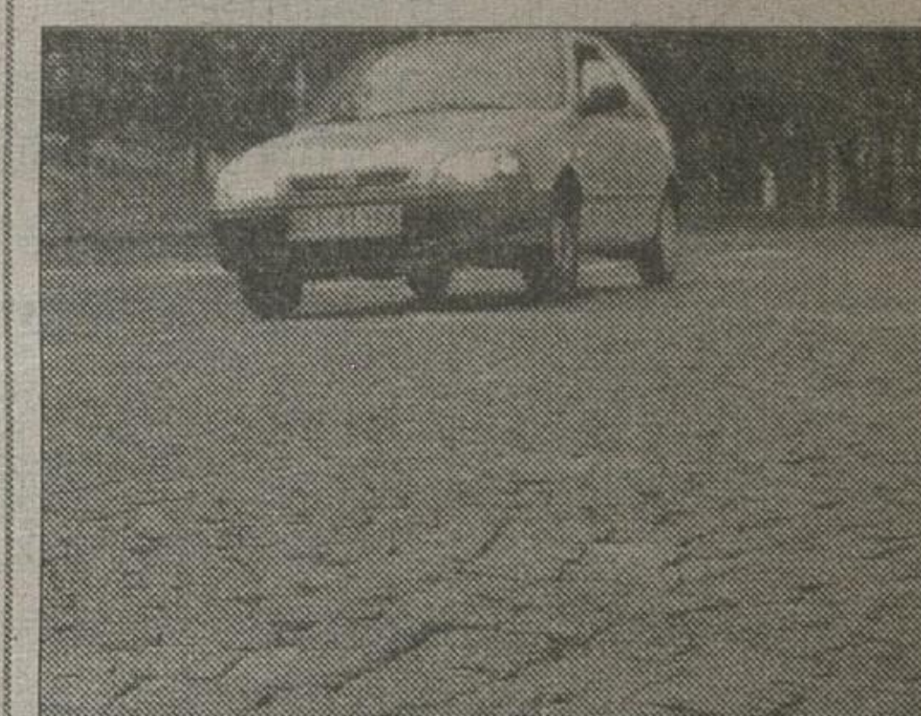
Kalinowskiego. Jedna z kilku ulic w centrum z nawierzchnią z kostki kamiennej. Niestety, bardzo nierównej. Urząd Miejski chce w tym roku rozpocząć remont ulicy i placu Uniwersyteckiego.
