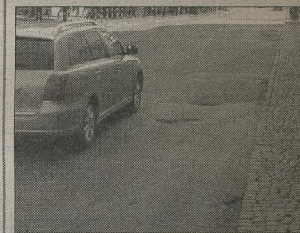
Skłodowskiej. Po tej ulicy trudno jeździć, żeby nie „zgubić” kół. Na szczęście w tym roku rozpocznie się jej remont. Także odcinka obok „Centralu”, fatalnie wyremontowanego w 1998 roku.
