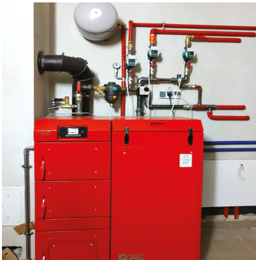
RYS. 15. Instalacja CO wykorzystująca piec na pellet
