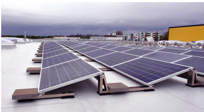
RYS. 8. Instalacja fotowoltaiczna zamontowana na płaskim dachu
