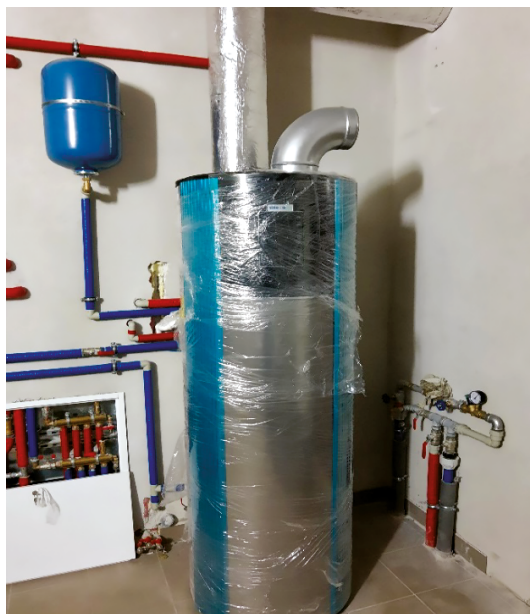
RYS. 17. Pompa ciepła do przygotowywania c.w.u. wykorzystująca powietrze
