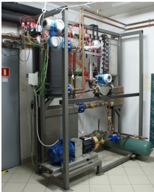
Rys. 6.28. Widok głównego modułu prototypowego strumienicowego układu chłodniczego o mocy napędowej do 100 kW
