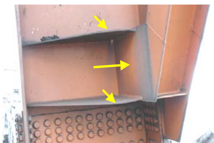
Rys. 1. Zdeformowany węzeł ładowarki
