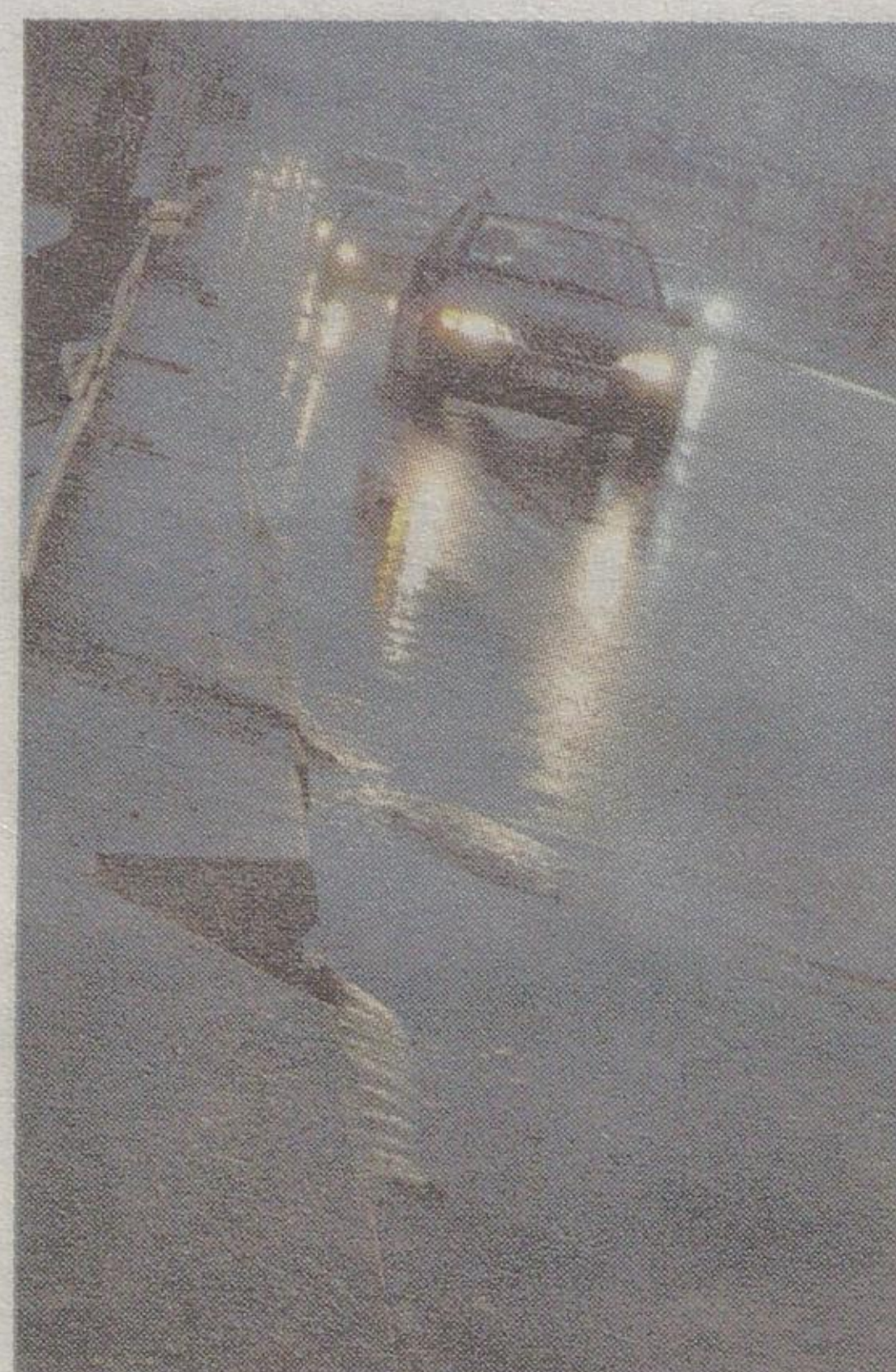
Woda nie spływała z wiaduktu. Studzienka była zapchana.
