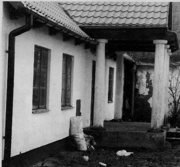
Przy zaniedbanym wejściu do dworku sterta śmieci
