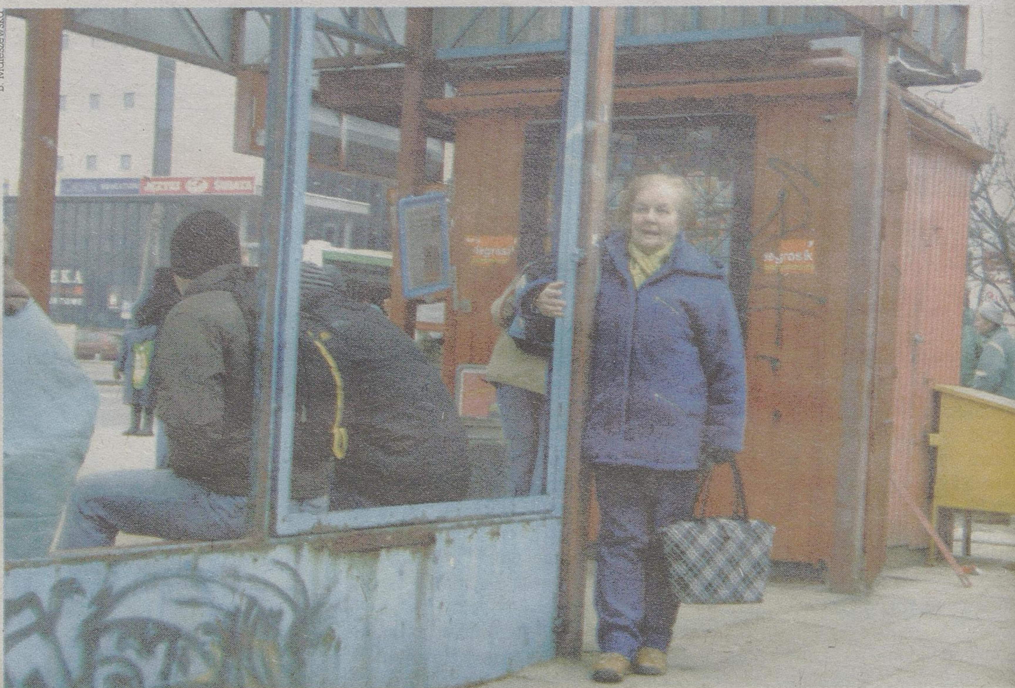
Czy to jest zabezpieczenie przed deszczem i wiatrem? – pyta z ironią pani Wanda Ogrodnik z Białegostoku, która prosi o jak najszybszą naprawę przystanku
