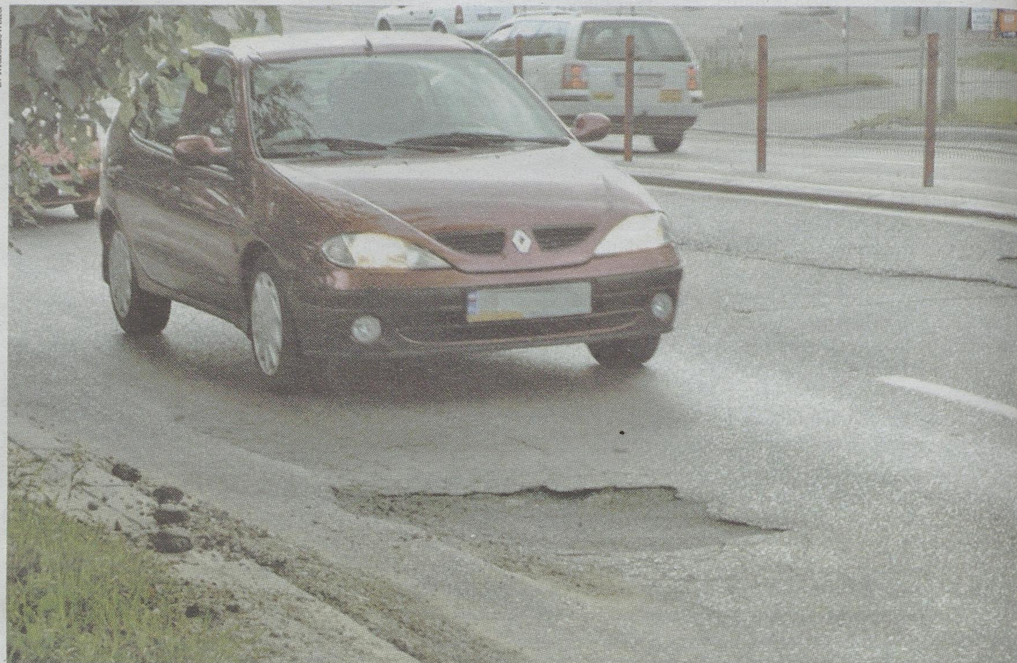
W czwartek przed południem nasz Czytelnik zaalarmował o dziurze na ulicy Kolejowej, a już po południu – po naszej interwencji – została załatana
