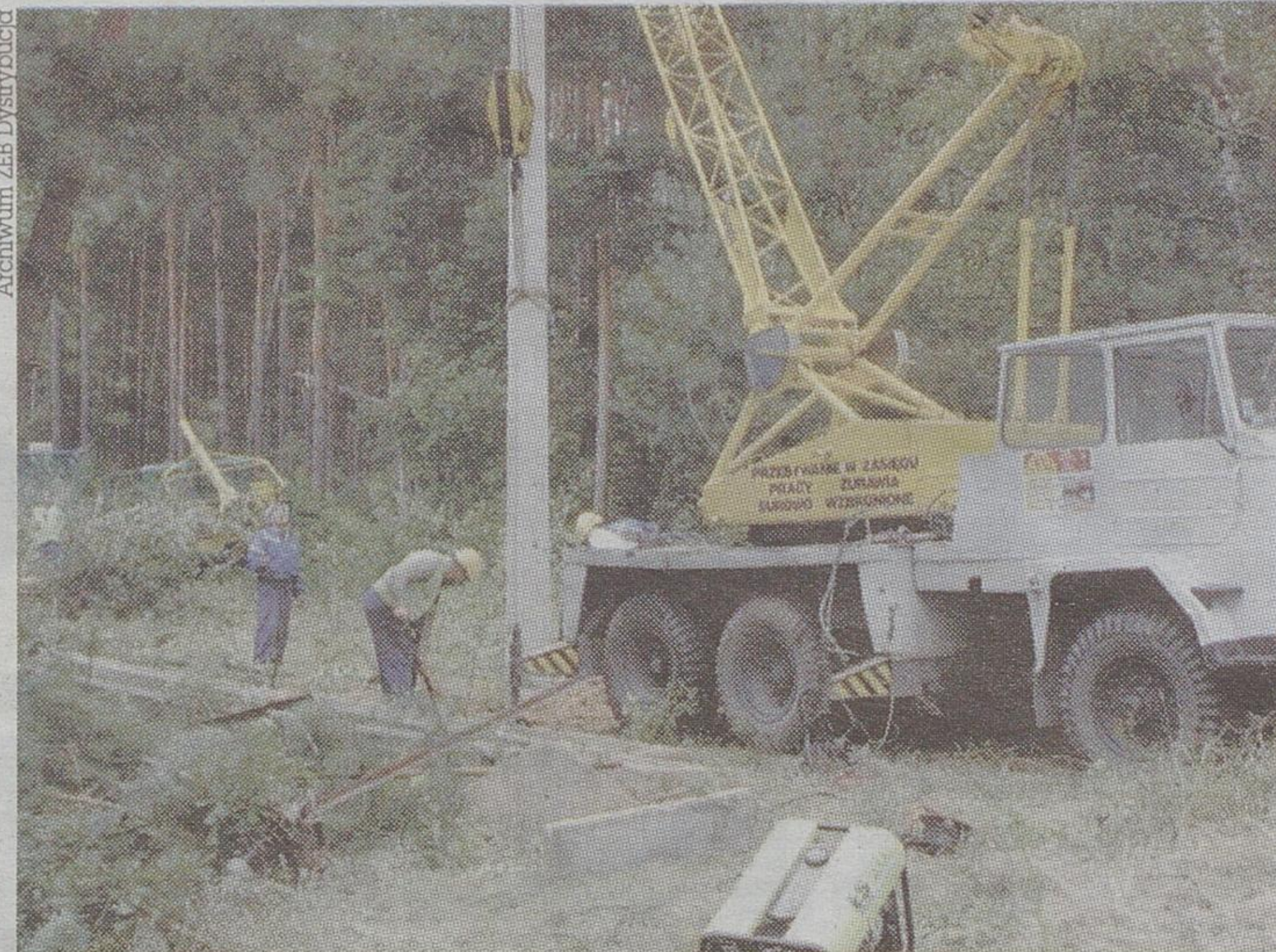
W niedzielę energetycy naprawiali szkody wywołane przez wichurę m.in. w okolicach wsi Mścichy koło Wysokiego Maz.
