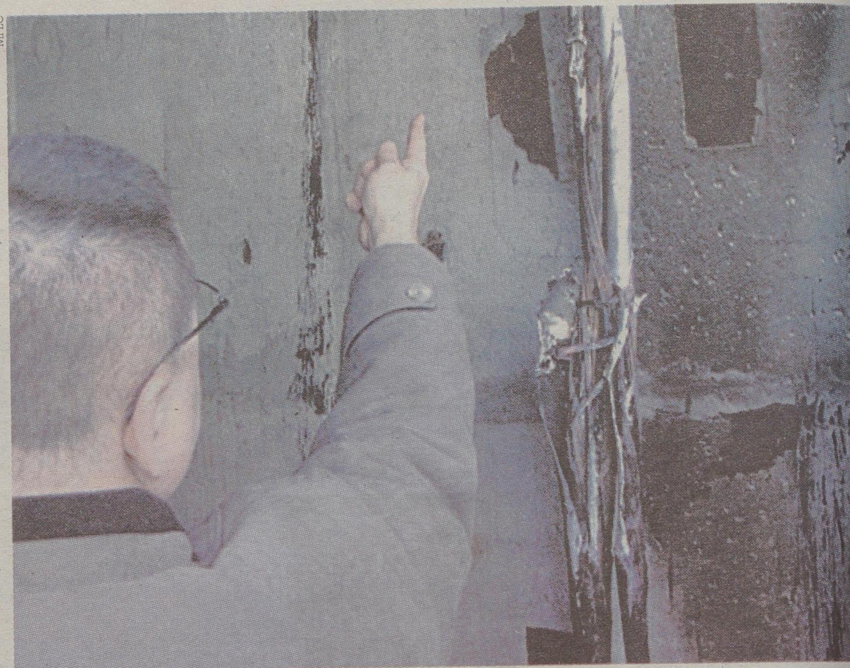
Jak wykazała wizja, ktoś celowo przeciął kabel w okolicach niewielkiego tunelu łączącego ul. Octową z Zielonogorską. Zasila on Ciepłownię Zachód.
