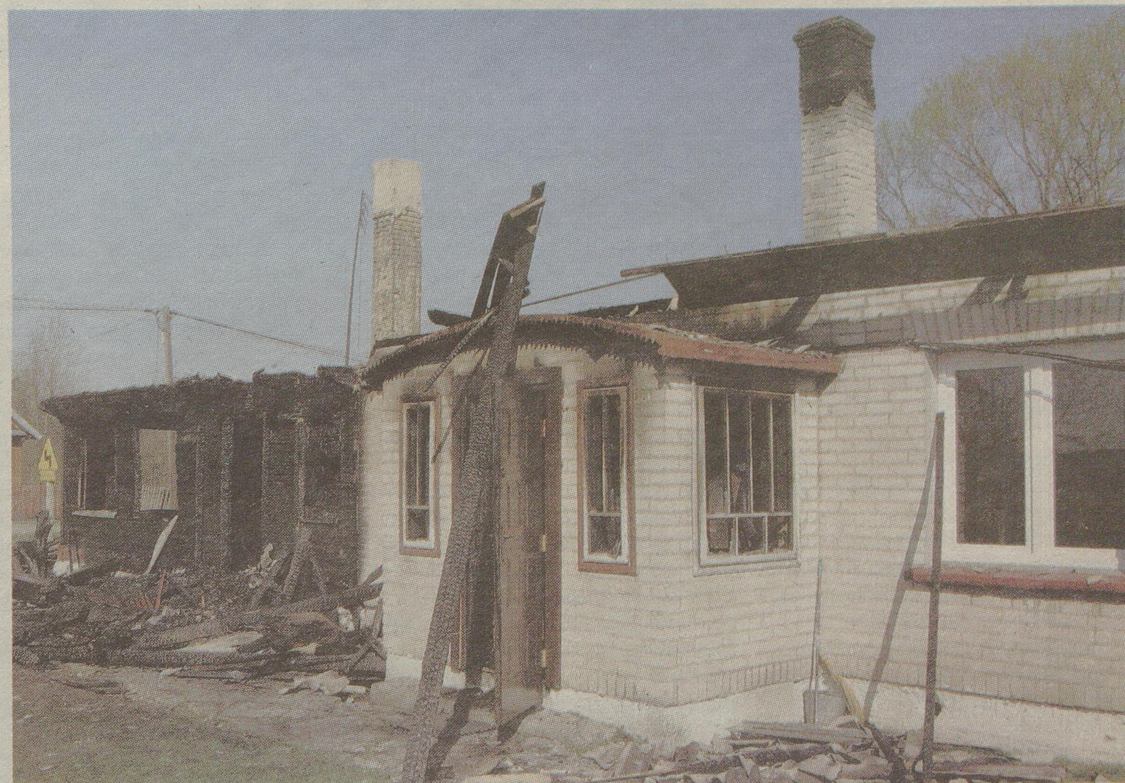
Ogień zniszczył większość domu. Strażakom udało się ocalić jego murowaną część.
