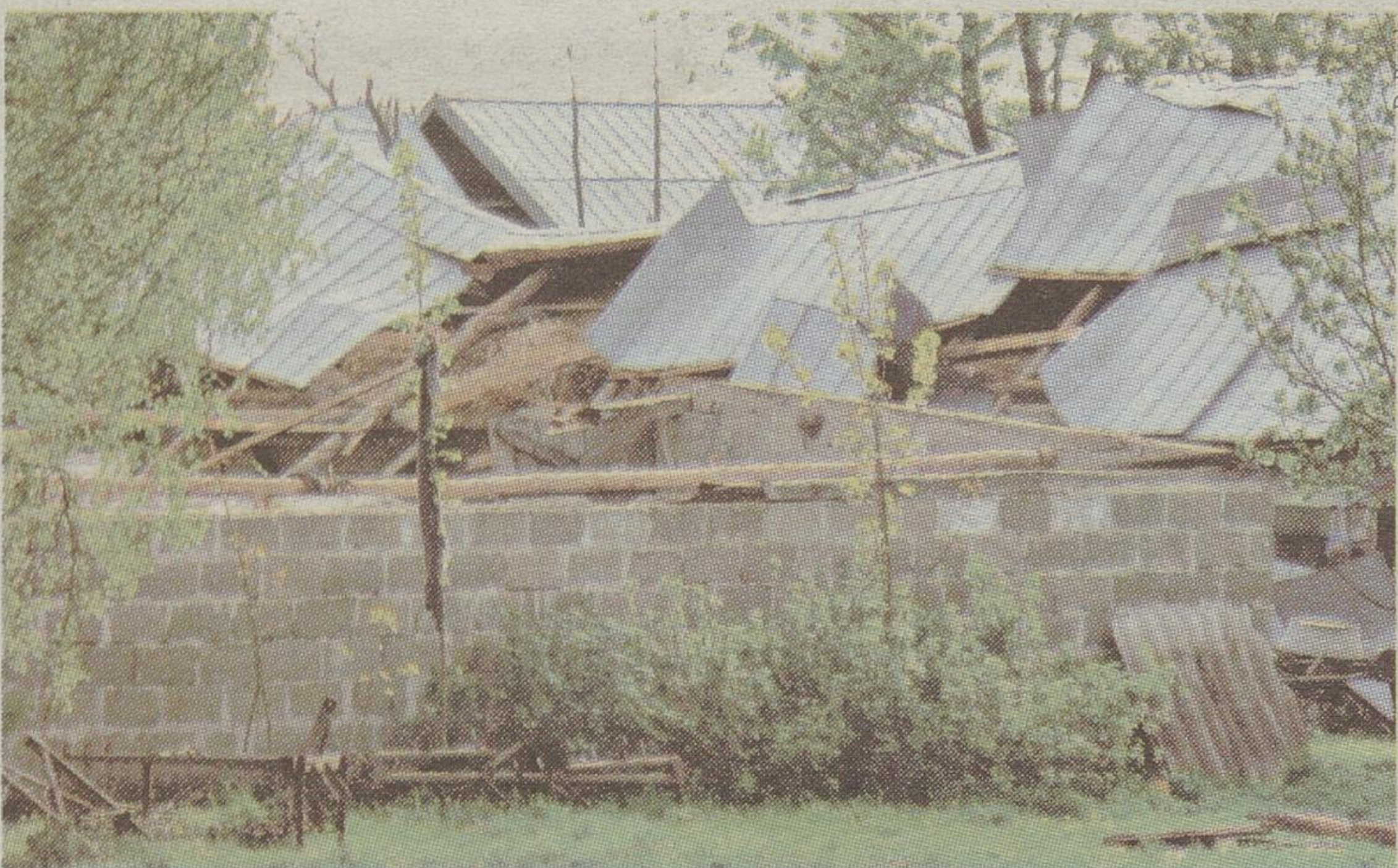
Tak po przejściu wichury wyglądał jeden z budynków gospodar- czych na podwórku Eugenii Szczerbac
