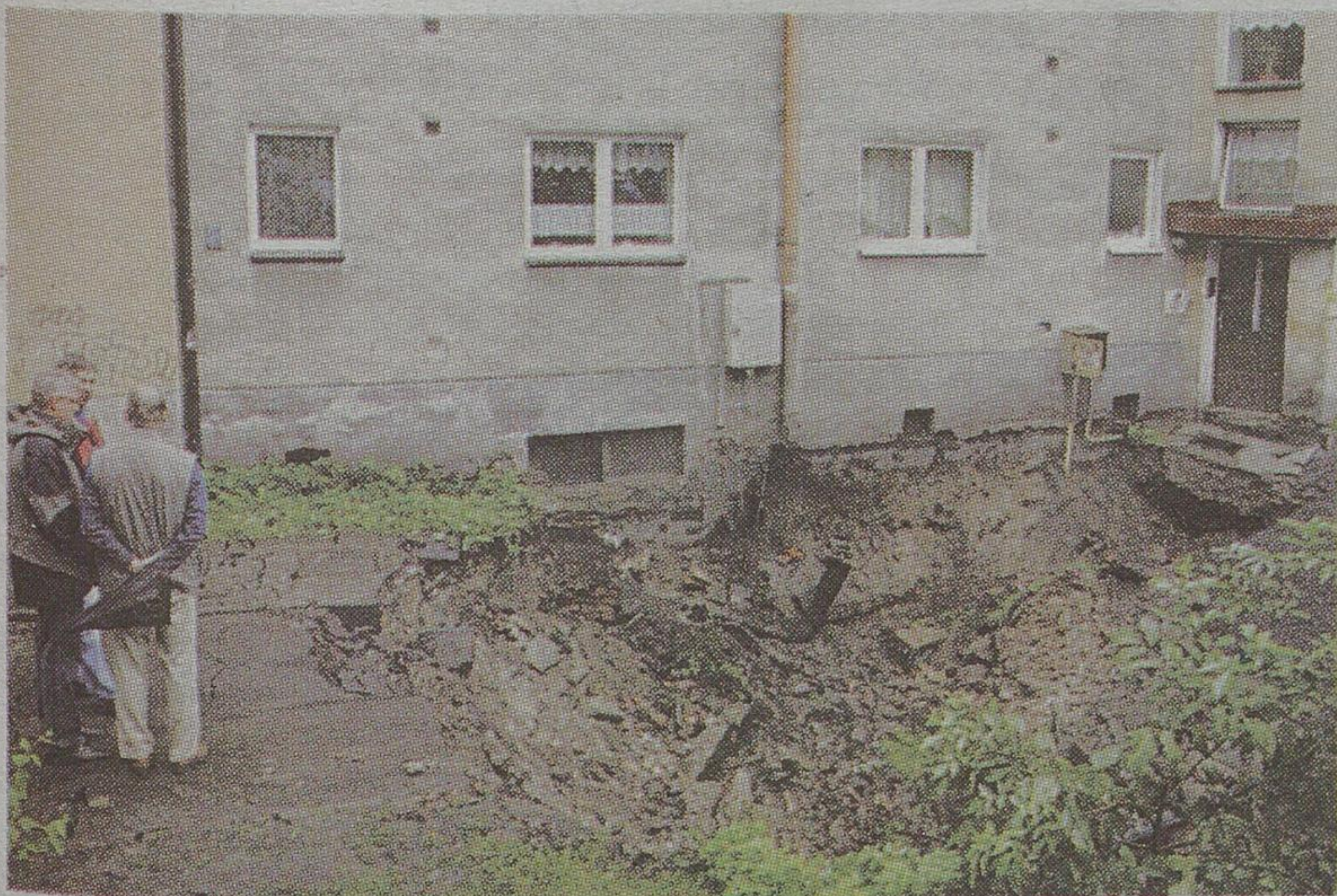
Zapadlisko tuż pod oknami mieszkańców miało 4 m głębokości
