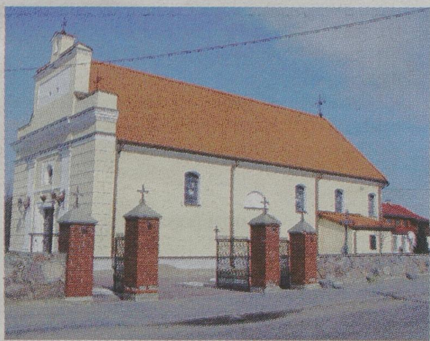
Kościół św. Wawrzyńca w Dolistowie z 1791 roku. Władze gminy kibicowały pozyskiwaniu przez proboszcza funduszy na remont dachu i elewacji.
